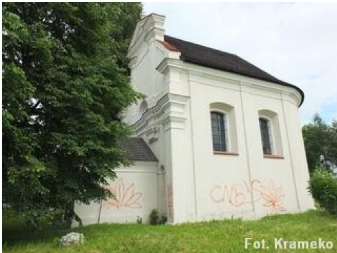
Fot. Krameko. Jerzmanowice, zdewastowana elewacja kaplicy pw. św. Jana Chrzciciela.
